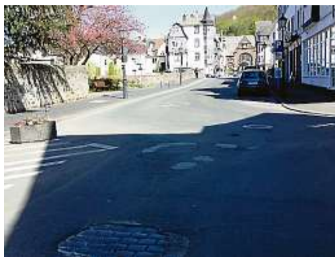
Löcherpisten und Flickwerk: Ab Montag der kommenden Woche lässt die Stadt Herborn in der Bahnhofstraße ...
