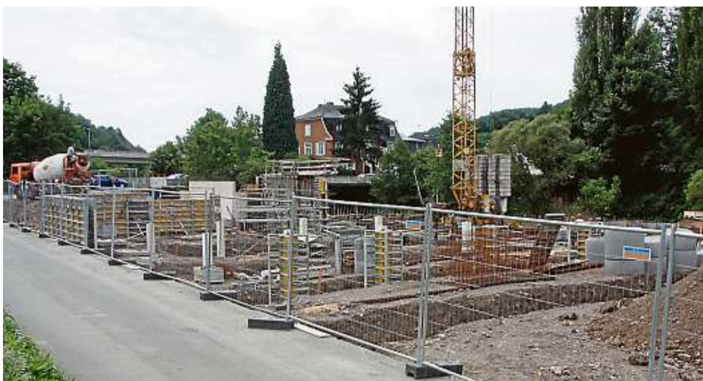
Das künftige Bürger Bürgerhaus wächst: Im Schnitt reichen vier Arbeiter völlig dafür aus, dass der Rohbau bis zum Herbst steht. (Fotos: Weirich)
